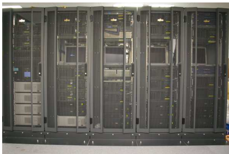
図 3.6: 本センター内の教育用計算機システムサーバ設備
